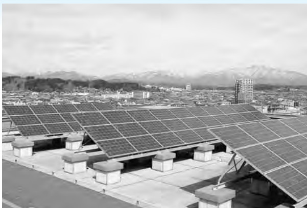
太陽光発電システム
