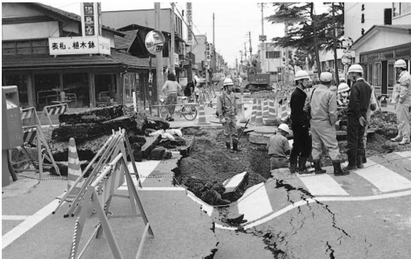
昭和58年5月26日、日本海中部地震が発生、道路に大きな亀裂(大町四・五丁目)
