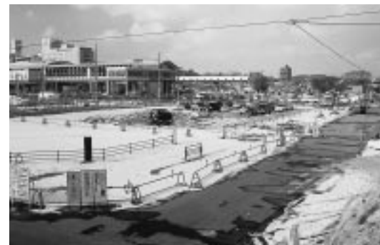
工事中の手形東通線。今年度中に約180メートルの区間が完成し、秋田駅東中央線に接続します
