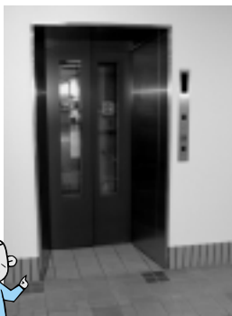
エレベーターも設置してあります
