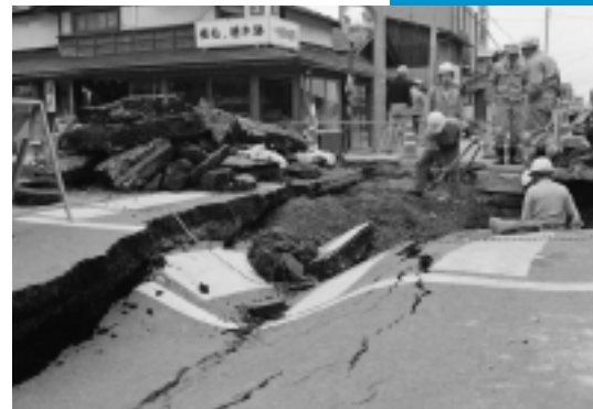
日本海中部地震で陥没した道路(大町)
