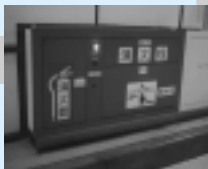
各所に消火栓を配置
