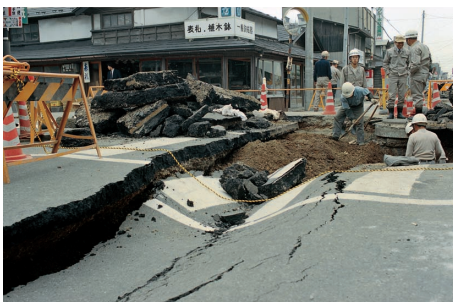
大町では道路が陥没しました
