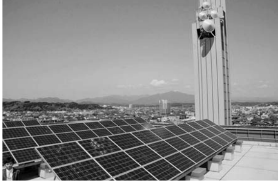
新エネルギーを活用します (アルウエ屋上の太陽光発電)
