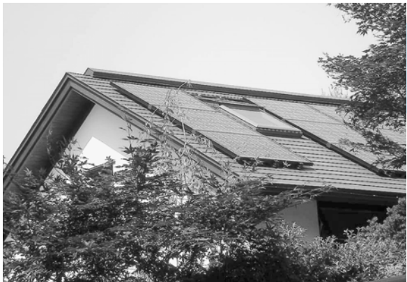
住宅用太陽光発電システム
