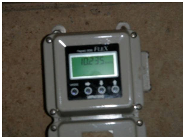
【取水ポンプ流量計の表示値(2011/10/18 10:11)】
