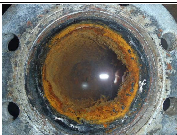
取水ピット 管内目詰まり状況
