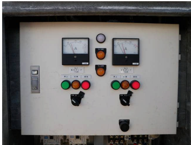
【清掃前の電流計、圧力計、流量計の表示】
