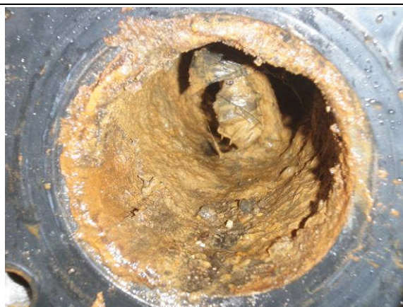
取水ピット 流量計付近管内目詰まり状況
