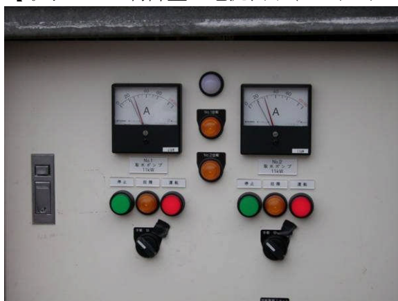
【取水ポンプ制御盤の電流表示(2011/10/18 10:00)】
