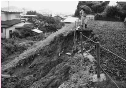
大雨で発生した土砂崩れ (8月14日、横森地区)
