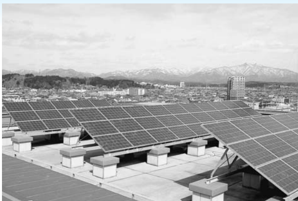
太陽光発電システム
