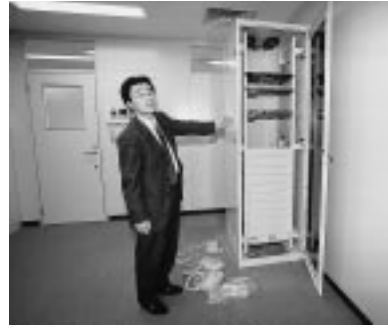
各部屋に高速大容量通信回線への接続口があります。
