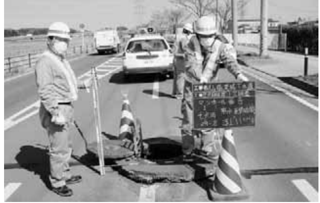
宮城県多賀城市で下水道管の被害状況調査(4月6日)
