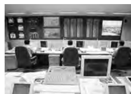
消防の通信指令室
