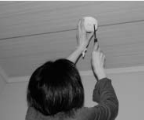
平成23年までの設置が義務付けられている住宅用火災警報器
