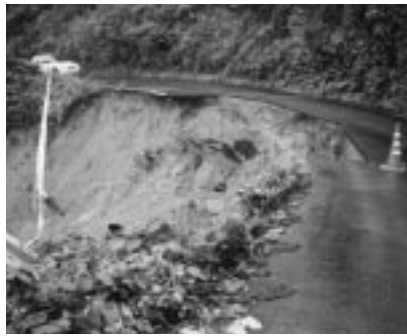
路肩が決壊した林道「新城線」
